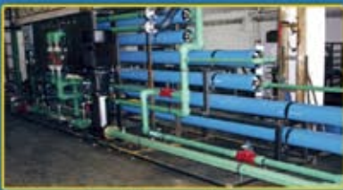
Ters Osmos Tesisi
