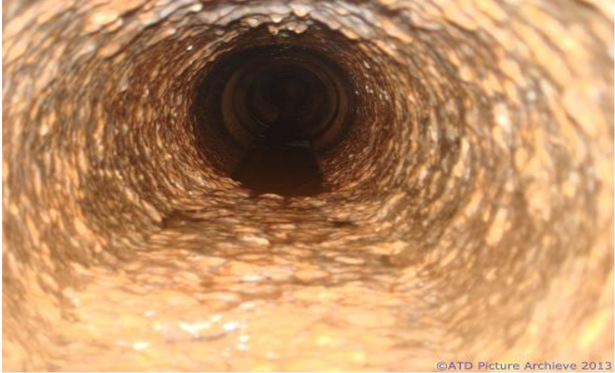
Şekil 5. Soğutma sistemlerinde oluşan bakteri kolonileri ve yarattığı korozif etkiler
