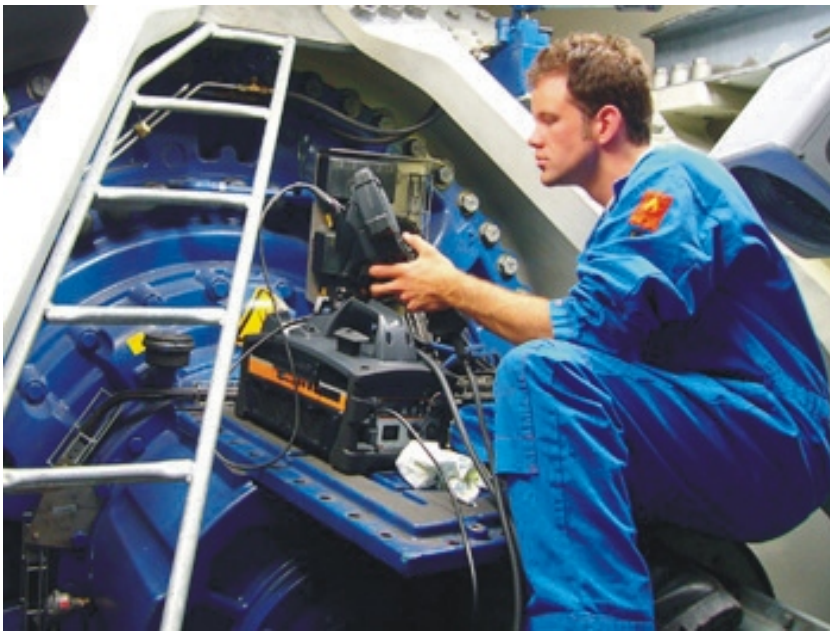
Şekil 2. Jeneratör Grubundaki Test Uygulaması
