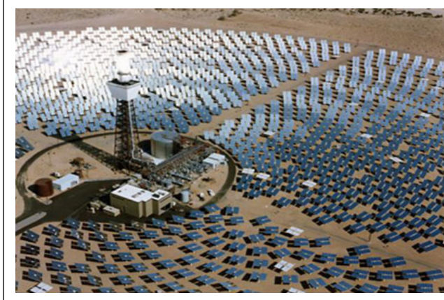
Şekil 11. Işınım Yansıtıcı Sistemin Görünümü
