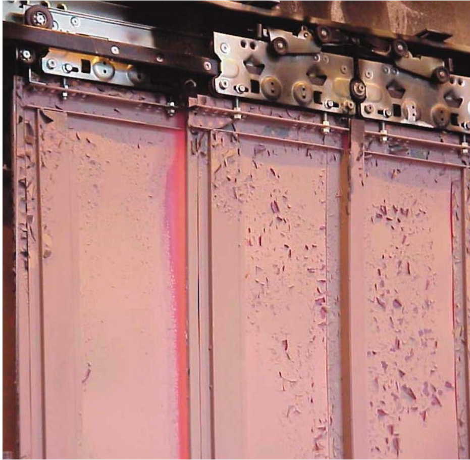
Şekil 4: Asansör Kat Kapısı Yangın Testi – Yüzeyler
