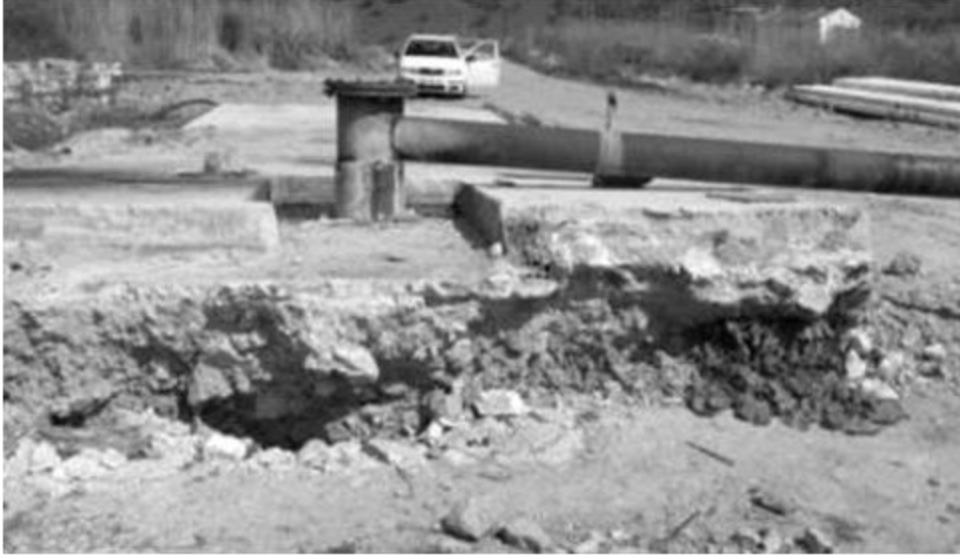
Şekil 3. Dikili Sahasında Zemin Oturmaları.
