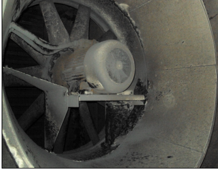
Şekil 3. Elektrik motorların direk fanların üzerine monte edilmesine ait bir görünüm
