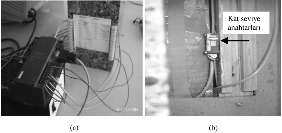
Şekil 4. (a) Sensör ve Motor bağlantı noktaları. (b) Kat seviye anahtarları.
