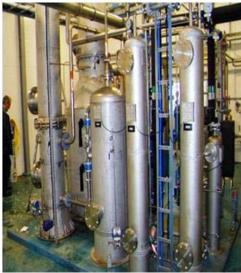
Şekil 3. Polietilen Glikol Ayrıştırma Ünitesi [5]
