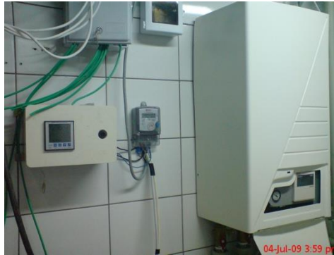
Şekil 5. Hava kaynaklı ısı pompası (sağda) ve şebeke analizörü (solda).
