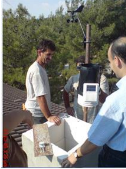
Şekil 3. Portatif meteoroloji istasyonunun çatıya monte edilişi.
