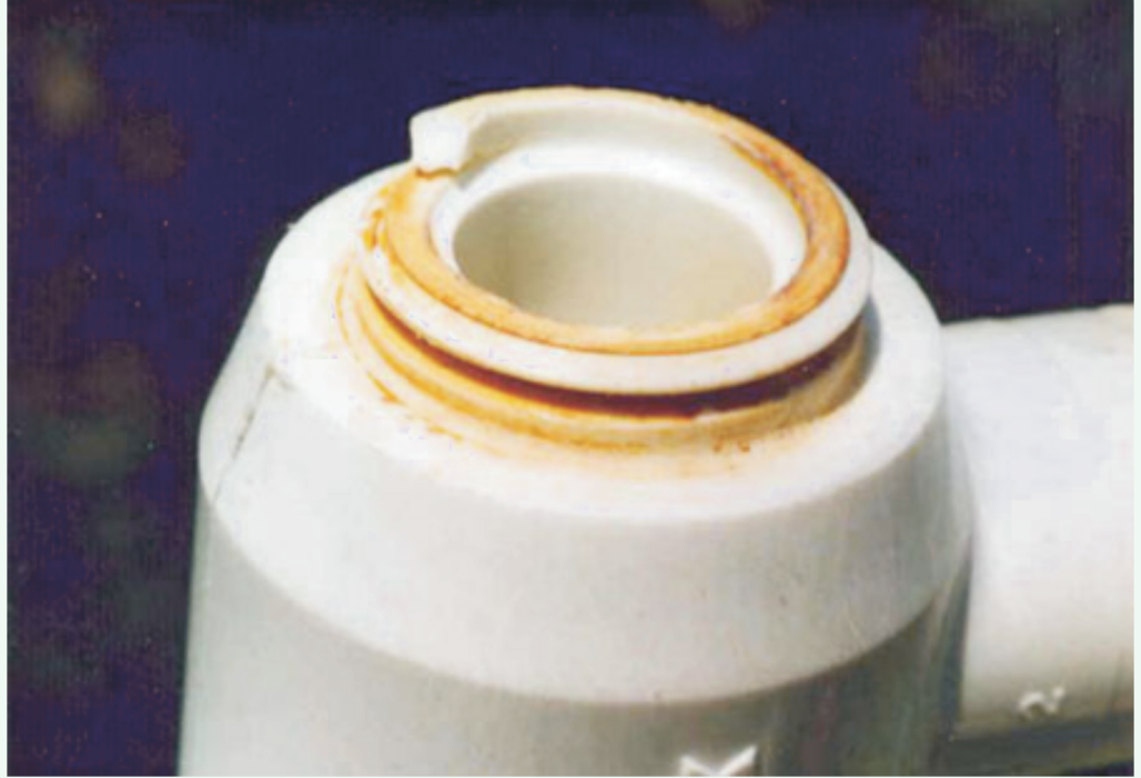
Bu polibütan boru, sudaki plastik ve klorun reaksiyonu sonucu hasar görmüştür.
