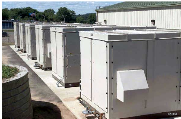
Şekil 7. 6 Adet Paralel Olarak Çalışan 200kW'lık Fosforik Asitli Yakıt Pilleri [1]
