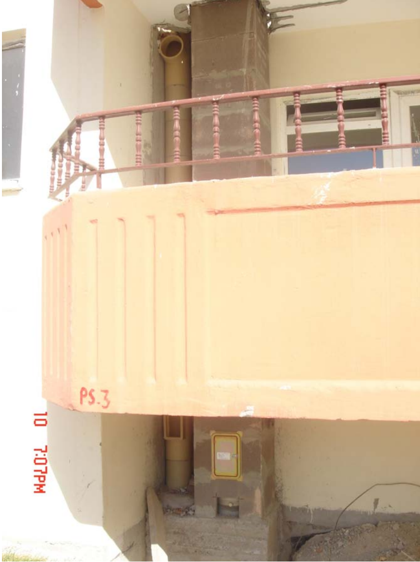
Şekil 113. Atık Gaz-Hava Bacaları
