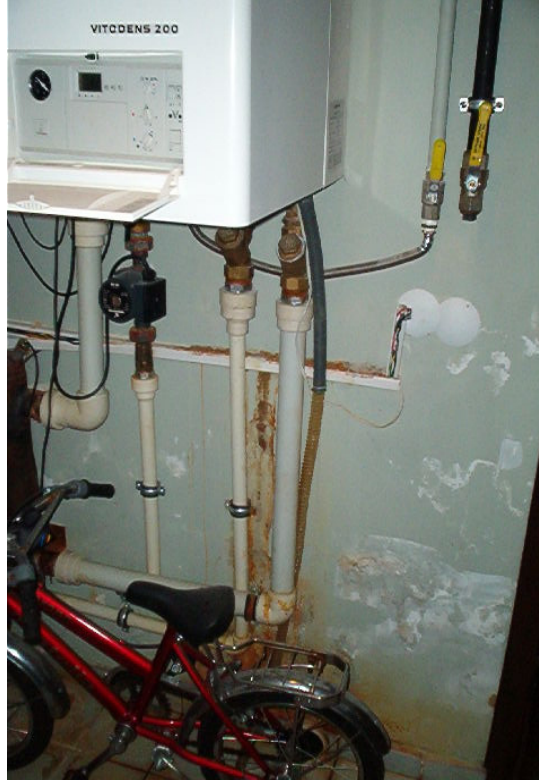
Şekil 69. Mevcut Sorun: Paslanma
