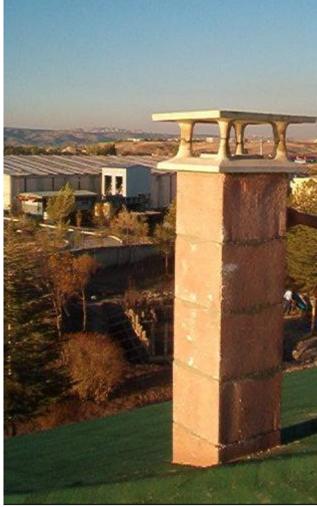
Şekil 36. İç Kısmı Seramik, Dışı Beton Blok İle Kapatılmış Seramik İle Beton Blok Arası Taş Yünü İle İzole Edilmiş Bir Baca
