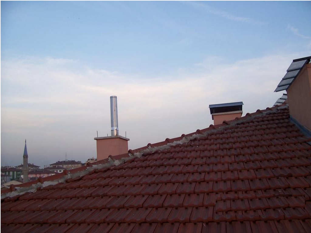
Şekil 65. Çatılarda Mahya Seviyesi Altında Kalınması, Ters Rüzgar Akımları Sebebiyle Baca Tepmeleri ve Çekiş Problemlerine Yol Açar.
