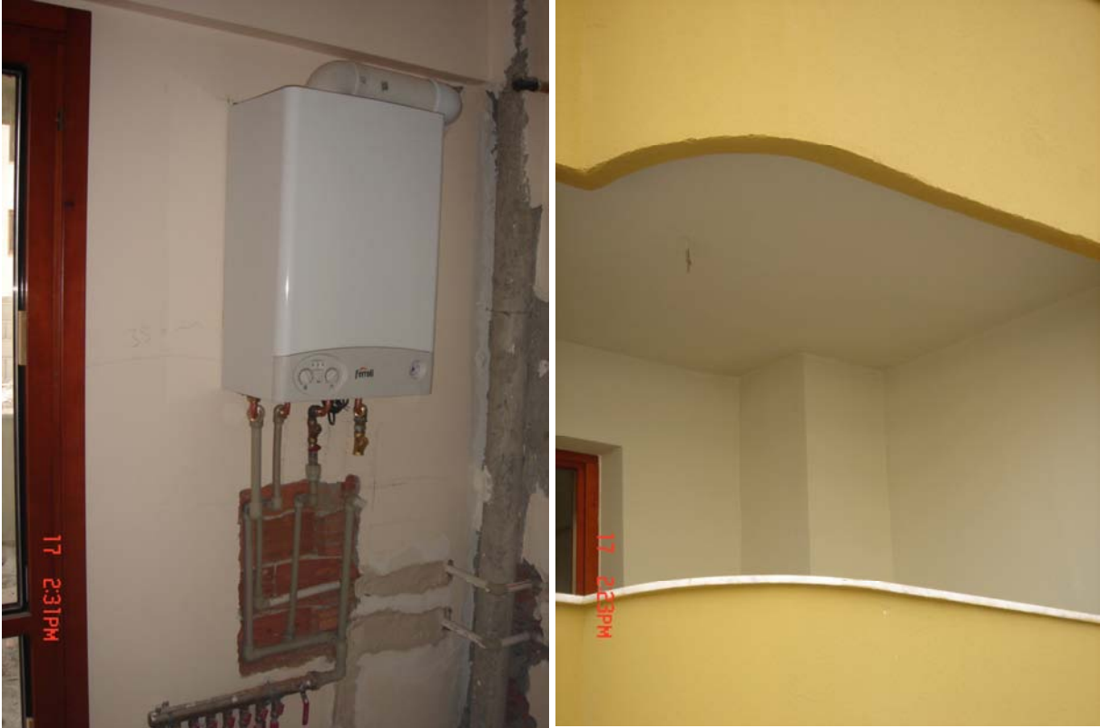
Şekil 117. Atık Gaz-Hava Bacaları
