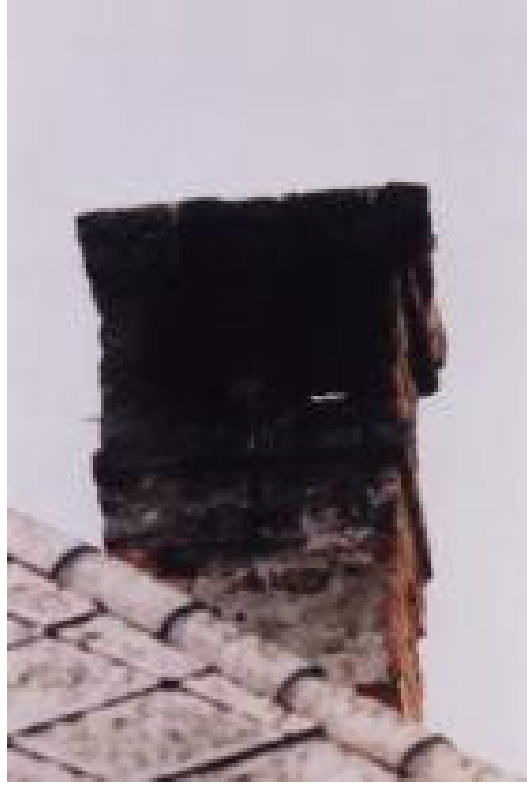
Şekil 64. Uygun Olmayan Baca Malzemeleri Kısa Zamanda Deforme Olarak Bacanın Çökmesine Neden Olmaktadır.
