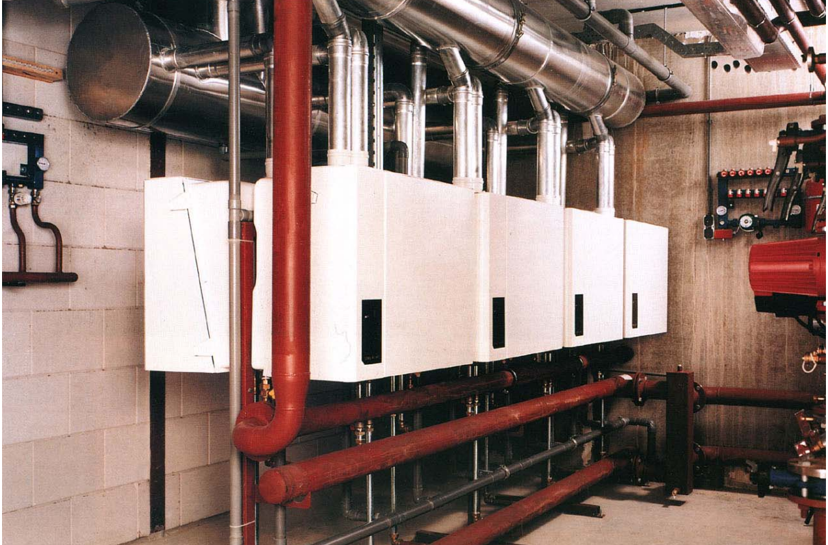
Şekil 5. Duvar tipi yoğuşmalı kazanlardan oluşturulan kaskad sistem
