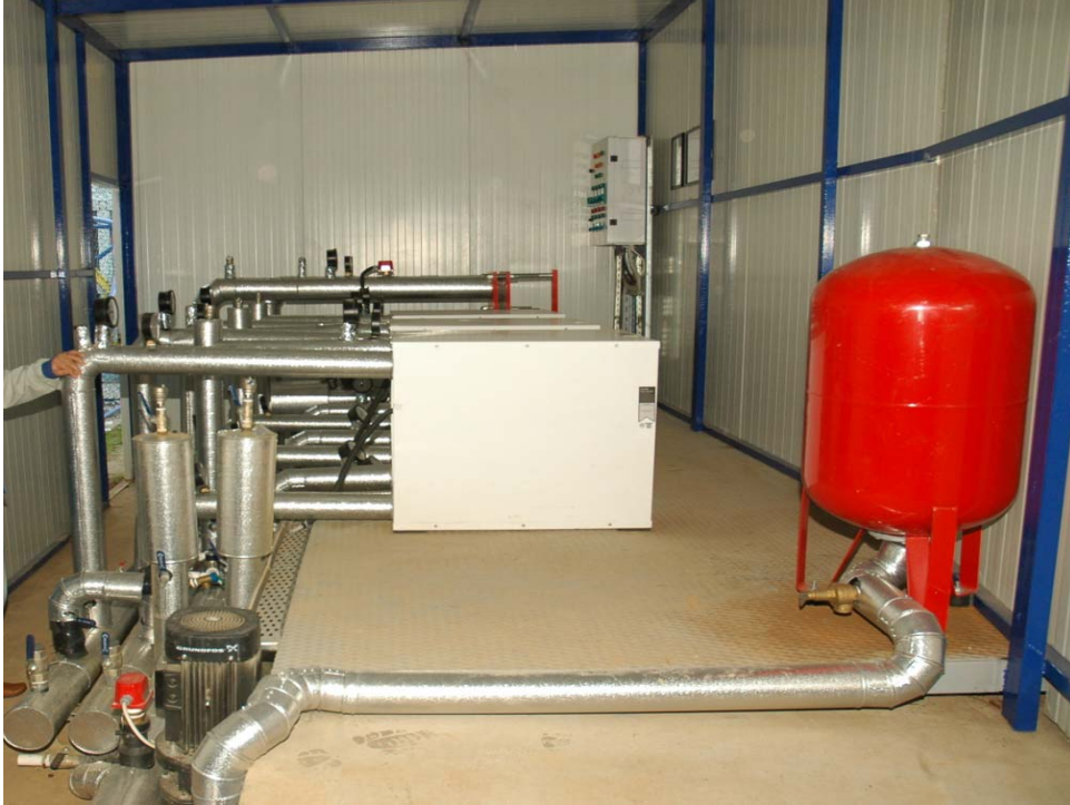
Resim 5. Isı Pompaları İle Oluşturulmuş Makine Dairesi [1]
