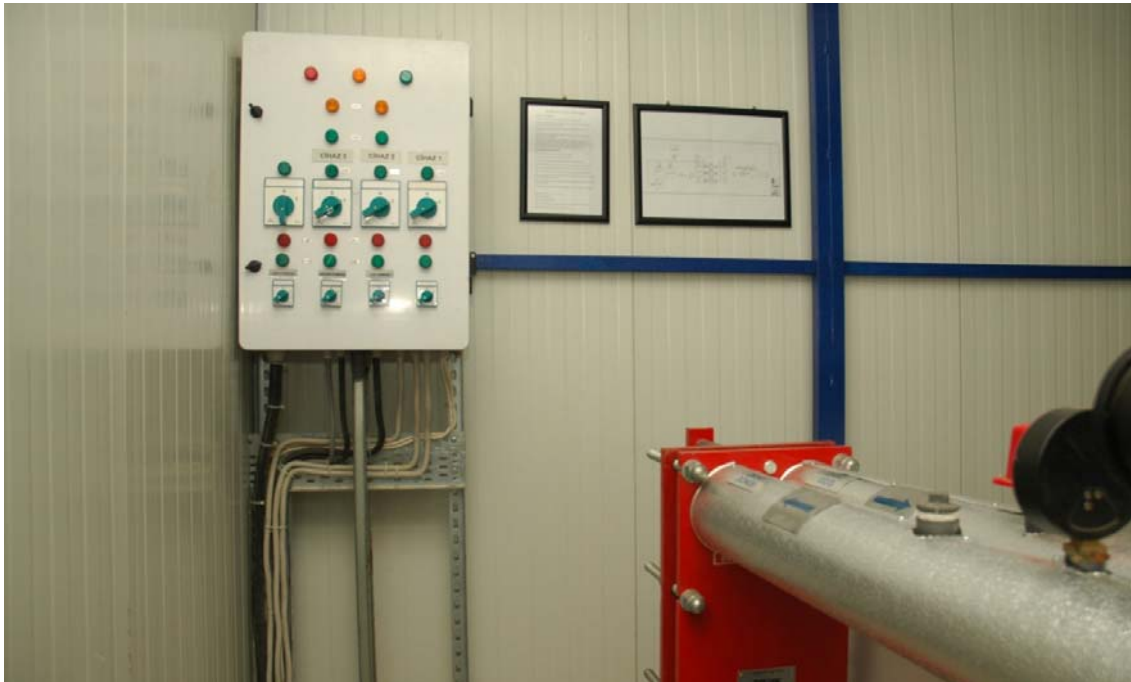
Resim 8. Isı Pompaları Makine Dairesi Elektrik Panosu [1]
