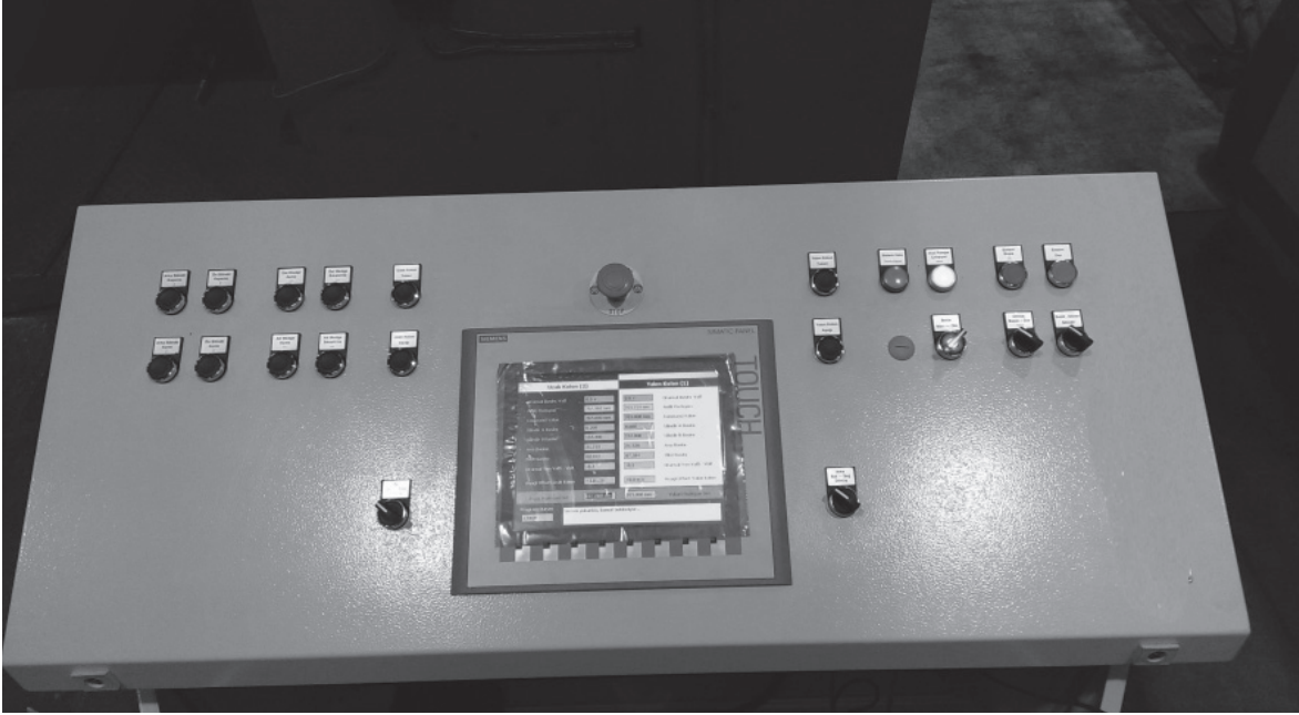
Şekil 16. Elektrik Kumanda ve Kontrol Sistemi
