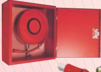
Bina İçi Yangın Dolabı ve Ekipmanları
