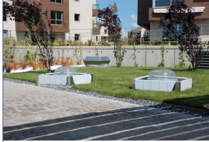
Bina zemin kat koridorunda gün ışığı aydınlatma üniteleri
