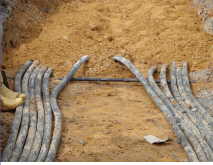
Kuyulardan saha kolektörüne çekilen yatay borular
