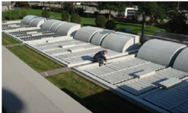
Şekil 5. Soğutma Kuleleri, Ekim 2006
