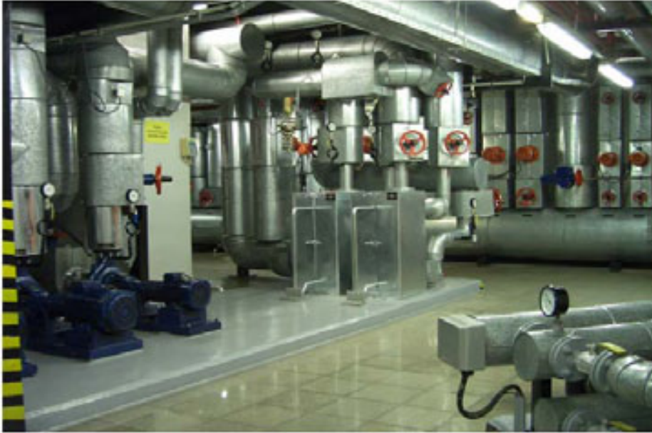
Şekil 13. Isıtma santralında izolasyon
