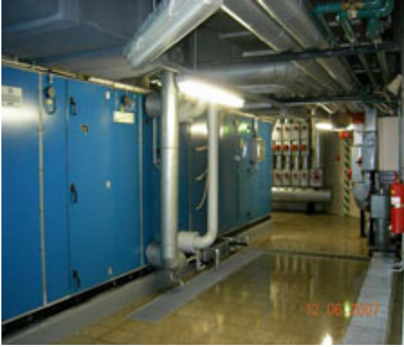
Şekil 23. Holding kule 14. tesisat katı
