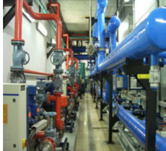
Şekil 34. Soğutma kulesi tesisatı ve yangın pompaları
