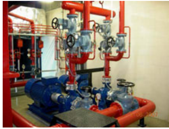
Şekil 32. 14. Tesisat katı sprinkler pompaları
