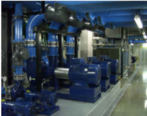
Şekil 21. Free cooling ve kondenser pompaları
