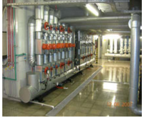
Şekil 30. 2 No'lu havalandırma santrali, ısıtma kolektörü
