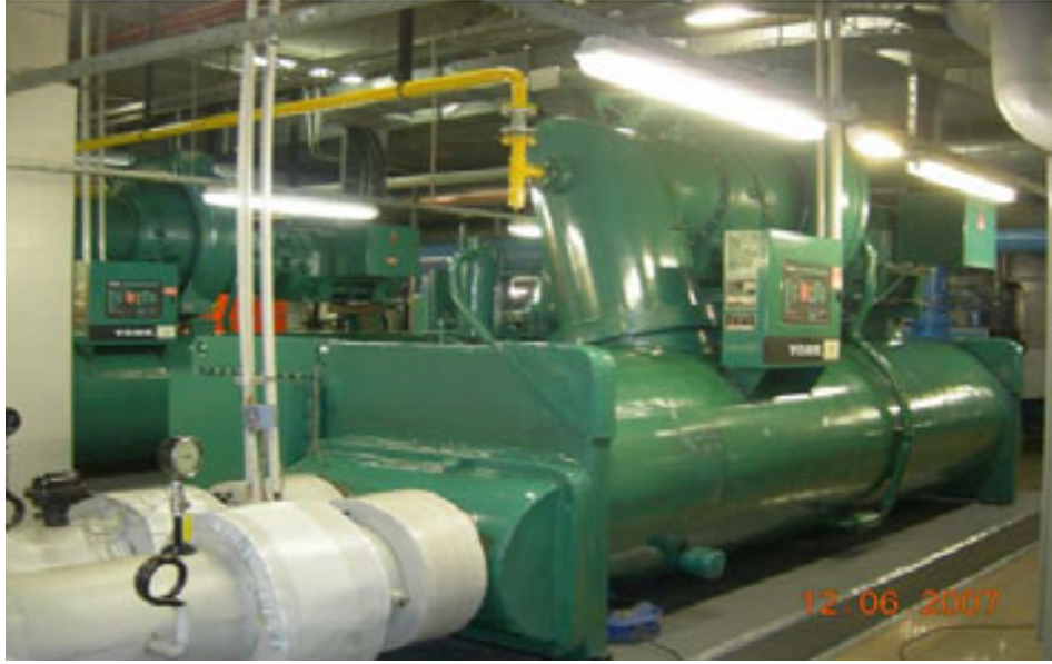
Şekil 6. Santrifüj Soğutma Grupları (2*3500 kW)
