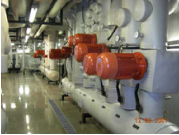
Şekil 31. Soğutma sant. ana dağıtım kolektörü
