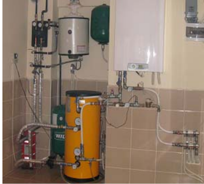
Resim 7. Makine Dairesi Tesisatı
