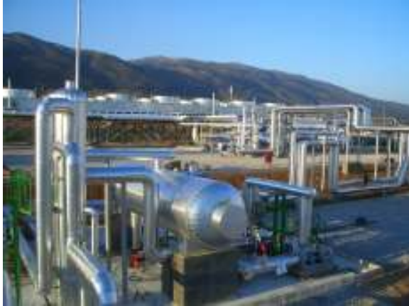
Şekil 2. Santralin genel görünüşü.
