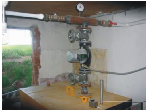
Şekil 9. Ana Isı Merkezinde Kombiden Seraya Sıcak Su Dağıtım Hattı
