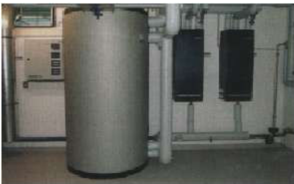
Resim 5: Inaalstadt Kliniği'ndeki temiz su ısıtıcı
