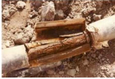
Şekil 1. Korozyona uğramış çelik boru bağlantısı
