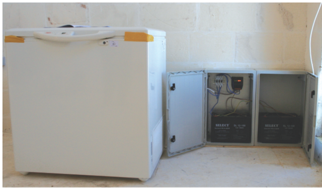
Buzdolabı-Solar kontrol ve batarya Grubu
