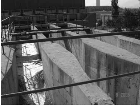
Debi Ölçüm Ünitesi (Parshall Savağı)
