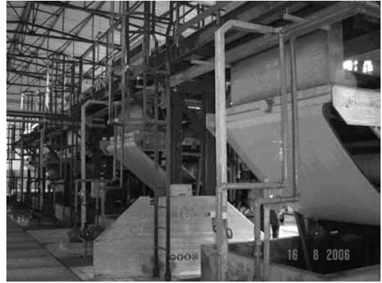
Çamur Susuzlaştırma Ünitesi
