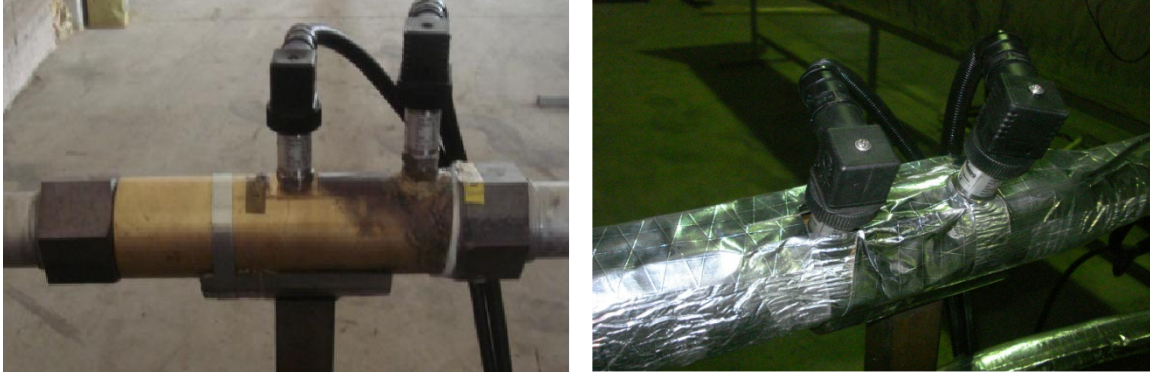
Şekil 10. Ventürimetre bağlantı görünüşü a. Yalıtılmadan önce b. Yalıtıldıktan sonra
