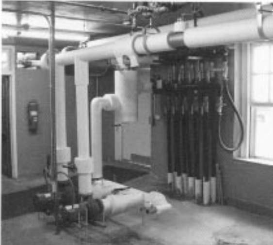
Auburn Belediyesi doğal enerji kaynağı için yerin altına inen bir kapalı çevrim jeotermal sistemi kurdu.
