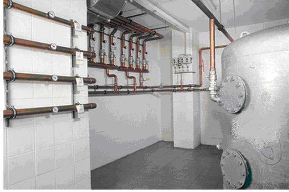
Şekil 16 Santralden Kolon Hatlarına Giden Medikal Gaz Boruları
