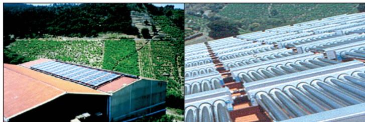
Şekil 3. Fransa’daki şarap mahzeninin ve kurulu güneş enerjisi sisteminin görünüşü
