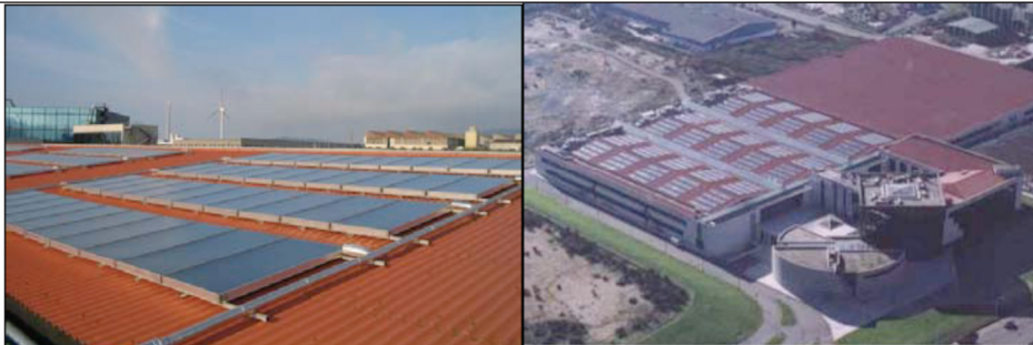
Şekil 5. İspanya'da Zara ofis ve dükkanına kurulan güneş enerjisi destekli soğutma sisteminin görünüşü
