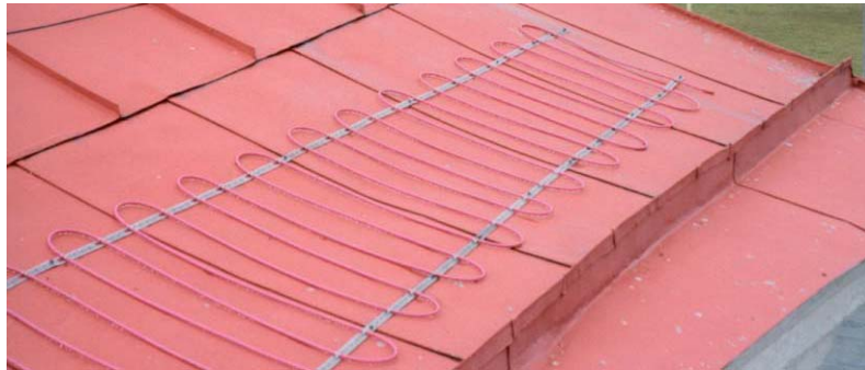
Resim 5. Oluklara, Çatı Kenarlarına Elektrikli Isıtma Uygulaması
