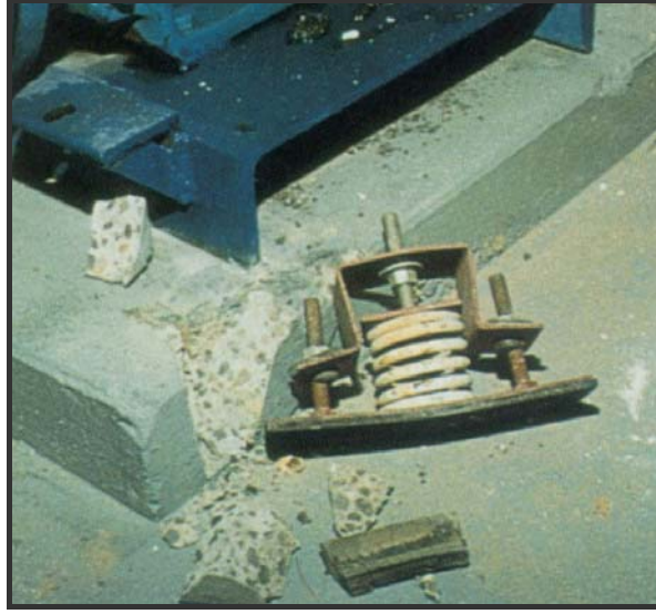
Şekil 4. Sismik İzolatör ile Beton Kaide Arası Bağlantı Hatasından Kaynaklanan Hasar [7]
