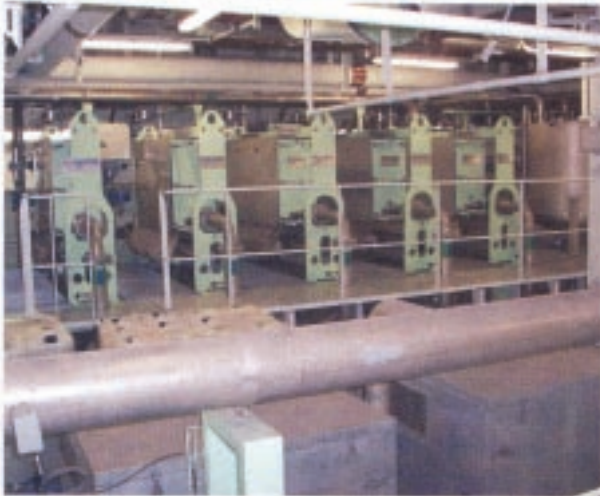
Queen Mary 2'deki atık su arıtma sistemi temiz suyu tekrar denize göndermekte.
