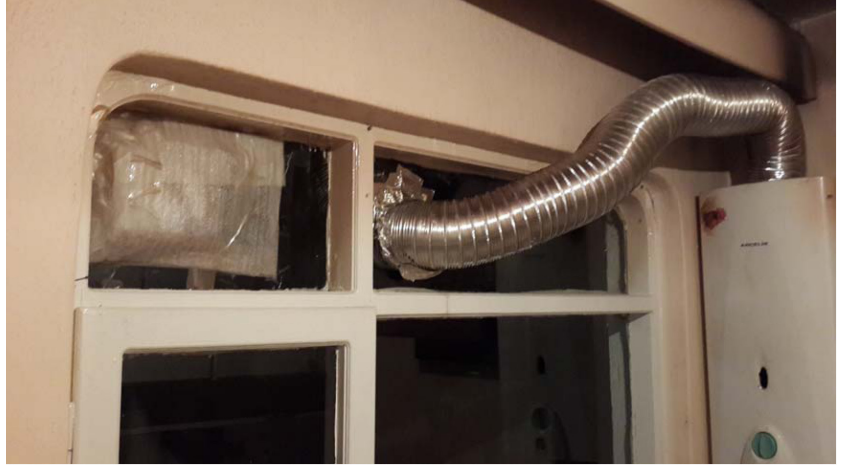
Mutfakta bulunan ve sıcak su elde etme amaçlı kullanılan Şofben ile havalandırma menfezlerinin kapatılmış durumu. Havalandırma menfezleri Oturma Odası ve Yatak Odasında da hava sızdırmaz şekilde kapatılmıştır.
