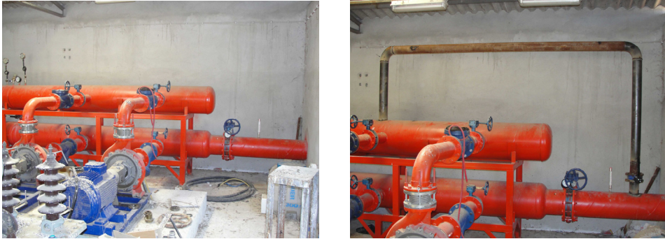
Şekil 16. Hisarköy Pompalama İstasyonunun Önceki ve Sonraki (DN100 By-Pass Hattı Montajından Sonraki) Görünümü.
