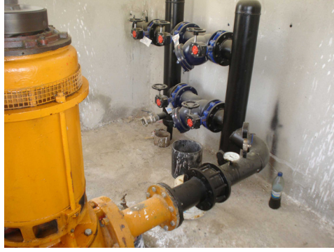
Şekil 4. Edremit JBIS'de Debi Ölçümü İçin Uygun Olmayan EDJ-4 Kuyu Tesisatı.
