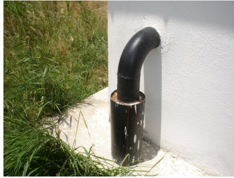
Şekil 5. Edremit JBIS EDJ-4 Kuyu Binası Dışında Ölçüme Elverişsiz Boru Parçası.
