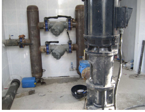
Şekil 7. Edremit JBIS'de Debi Ölçümlerine Elverişsiz EDJ-7 Kuyu Tesisatı.
