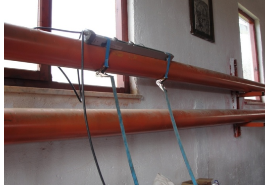
Şekil 10. Güre JBIS Isı Merkezinde Kuyu Debileri Ölçüm Çalışmaları.
