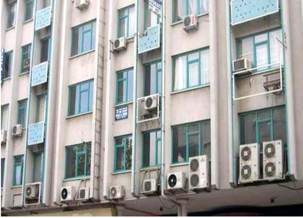
Şekil 5. Split Klima Dış Ünitelerinin Bina Cephesinde Oluşturduğu Görüntü Kirliliği
