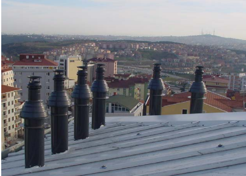
Şekil 4. Düşey Hermetik Baca Bağlantısının Çatı Üzerindeki Görünümü
